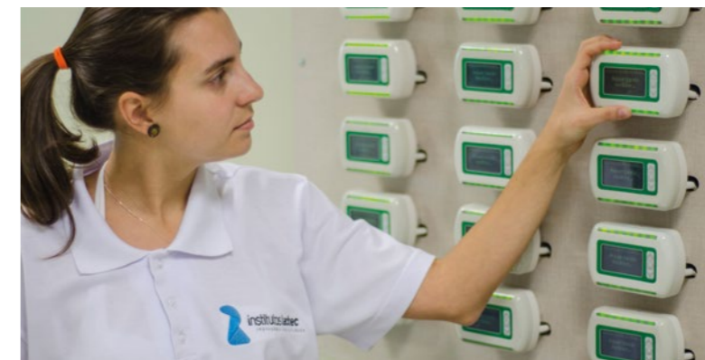
Sensor que monitora a rede elétrica desenvolvido pelos Institutos Lactec em parceria com a empresa de tecnologia Tecsys para a concessionária de energia Coelba. © Institutos Lactec
